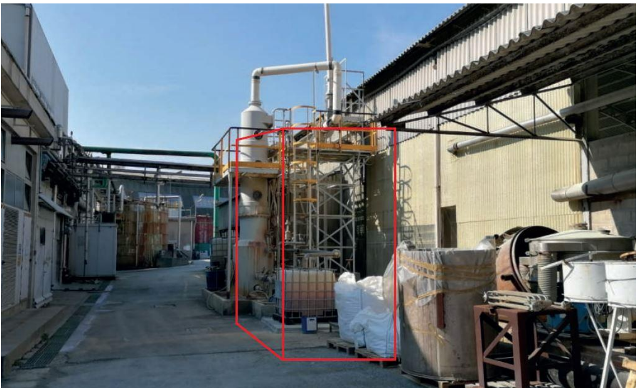
Fig. 7 - Scrubber nuovo fusore - Vista da Nord
