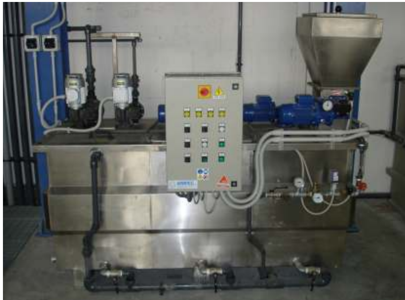
Esempio di preparatore automatico del flocculante
