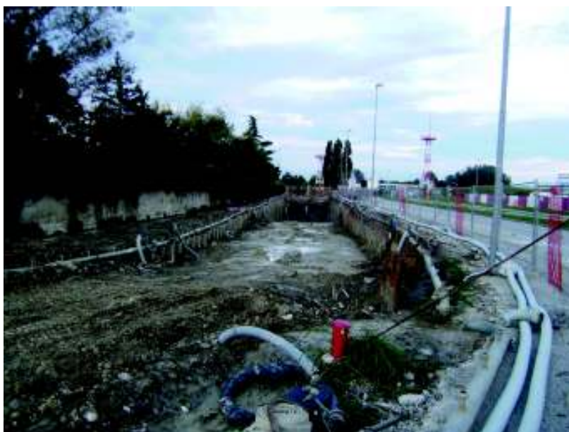
Figura 16. Immagine fotografica dei lavori di realizzazione del nuovo tratto tombinato dello scolo Pagliaghetta.
