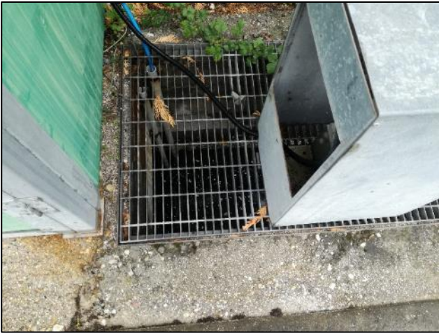
Fig. 1: Vasca impianto depurazione
