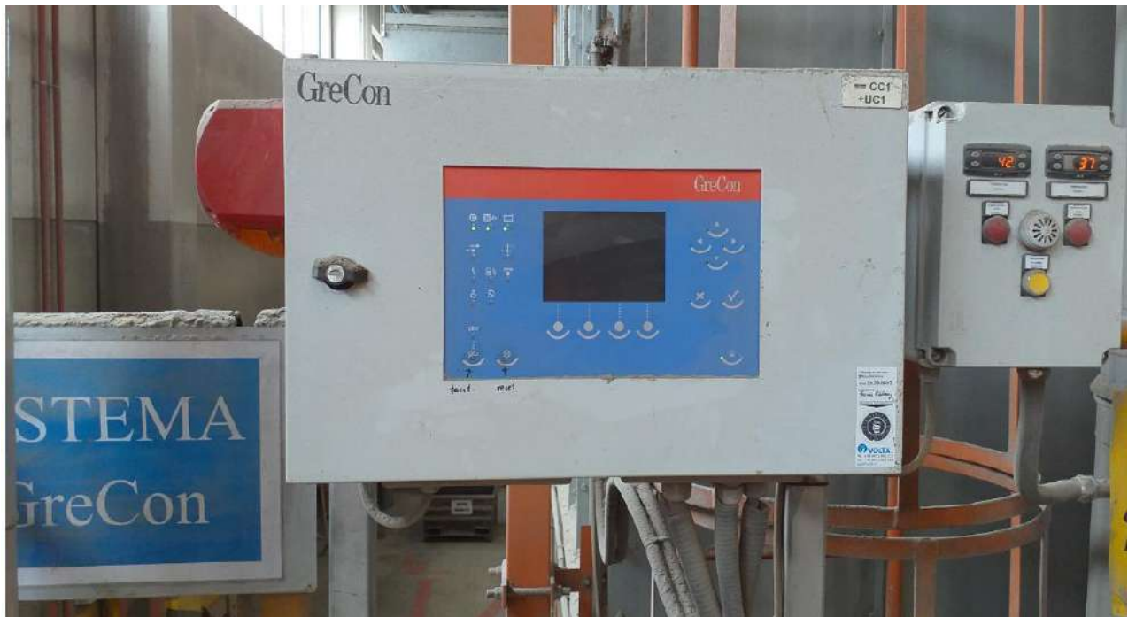
Sistema Grecon di segnalazione e spegnimento – Sistema di monitoraggio e segnalazione temperatura interna filtro 141 e filtro 142
