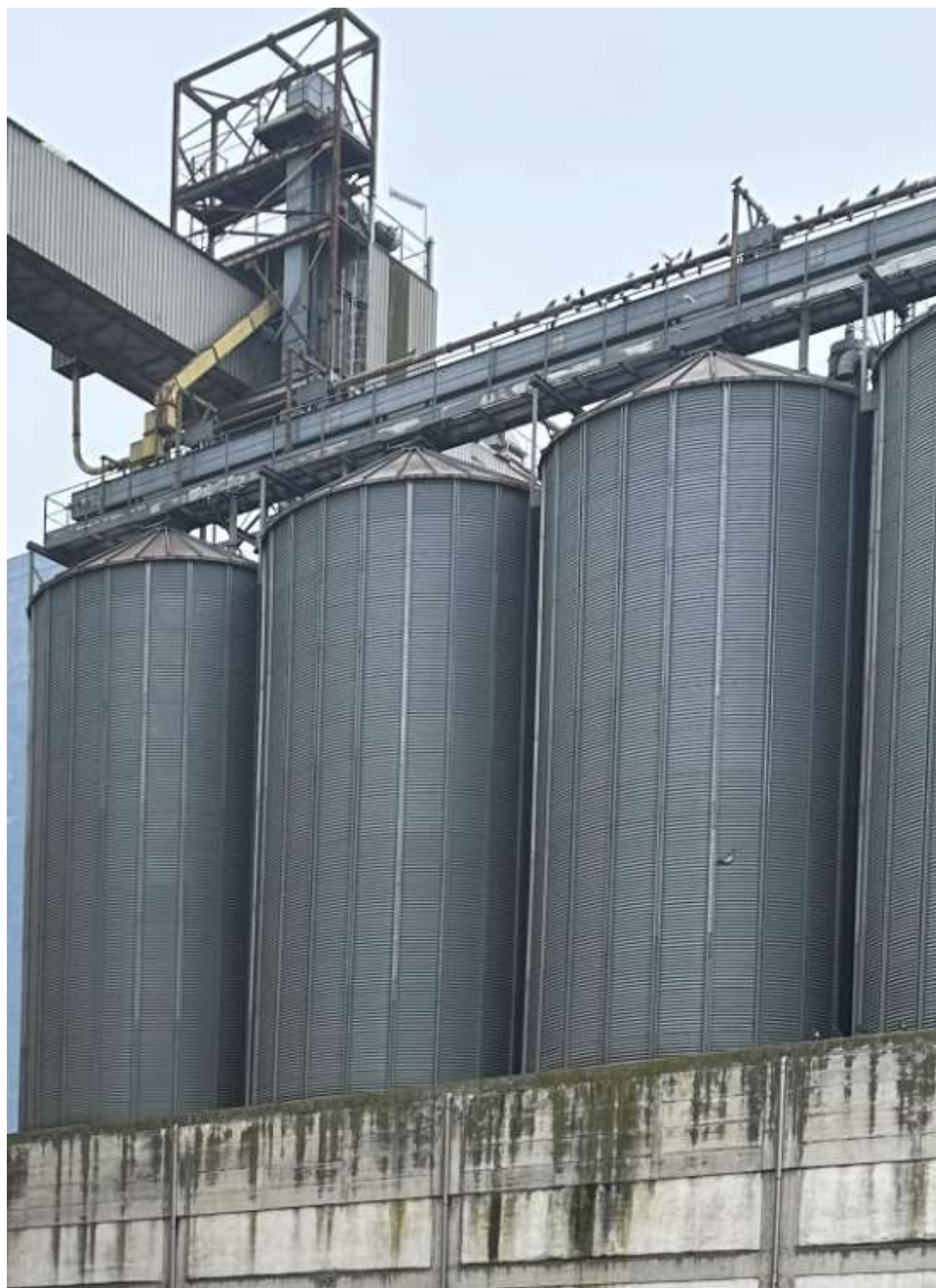
Figura 21: impianti tecnologici sui silos metallici
