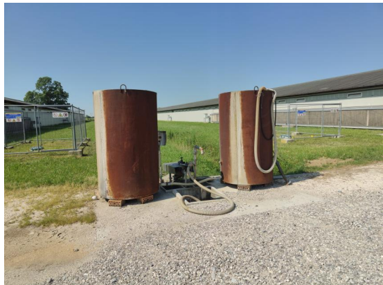
Serbatoi di accumulo per acqua da pozzo artesiano
