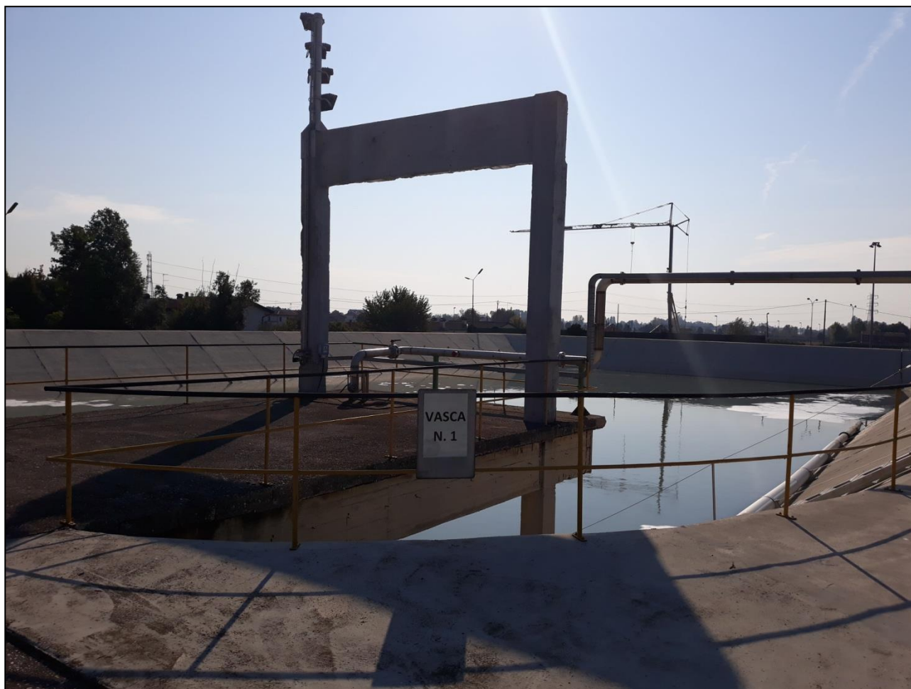
Figura 6 – Vasca di accumulo n°1 con tubazione di mandata all'impianto di depurazione.
